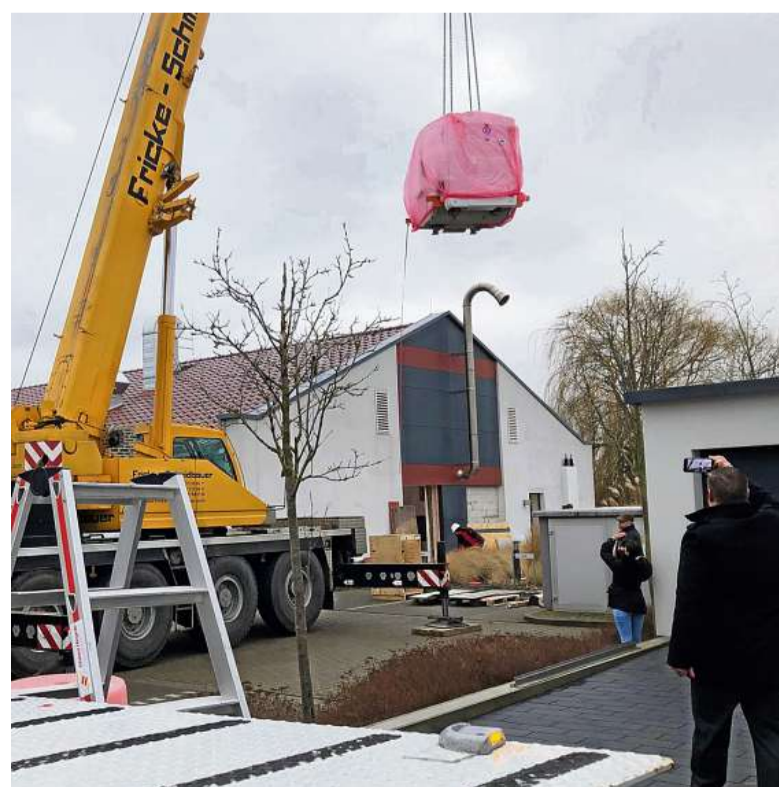
Per Kran musste der sieben Tonnen schwere MRT ins Radiologiezentrum Nordharz am Monplaisir 3 gehievt werden.
