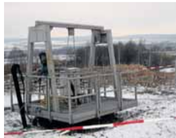
Der Sickerwasserzentralschacht muss saniert werden. Foto: LK
